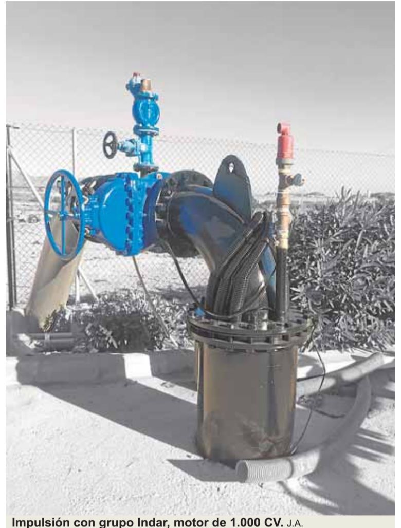
Impulsión con grupo Indar, motor de 1.000 CV. J.A.
